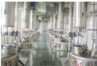
广药集团星洲药业——新车间内(立方储罐)
